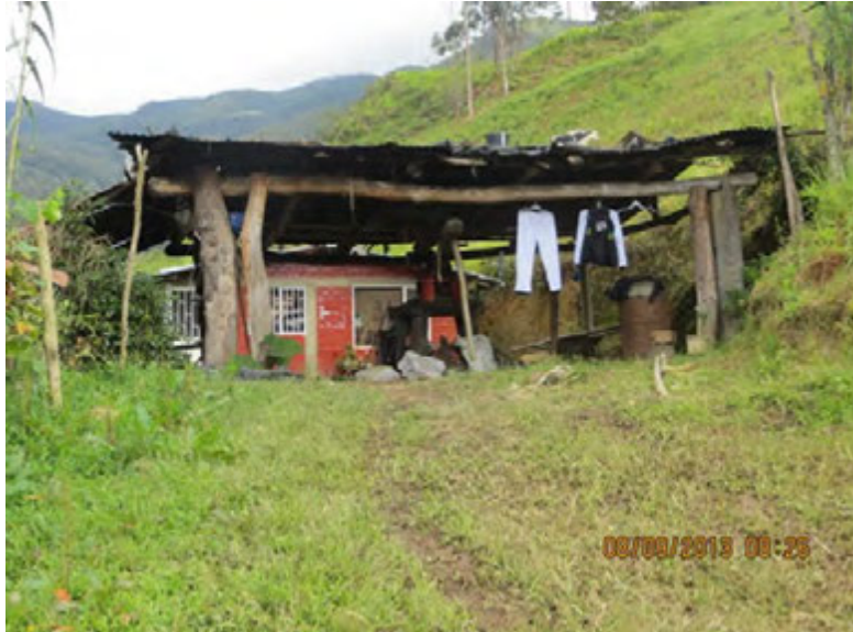
Fotografía 31. Vivienda afectada por el movimiento en masa que se da en el sector.
