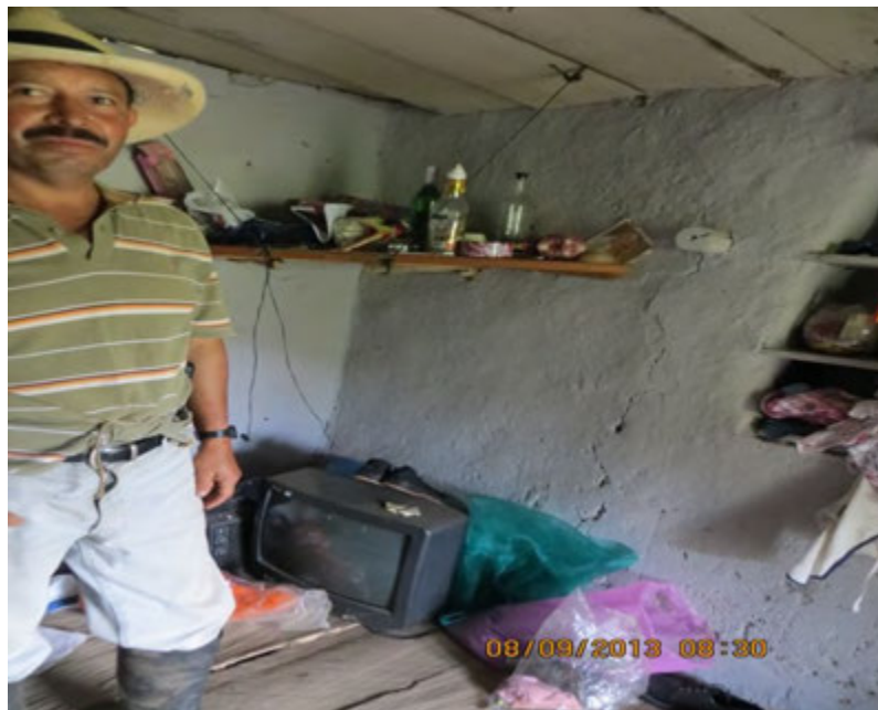
Fotografía 33. Parte de la construcción antigua de la vivienda que presenta fracturaciones en sus muros.
