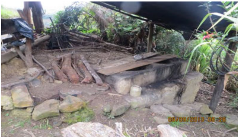
Fotografía 35. Trapiche de la vivienda afectado por el movimiento del terreno
