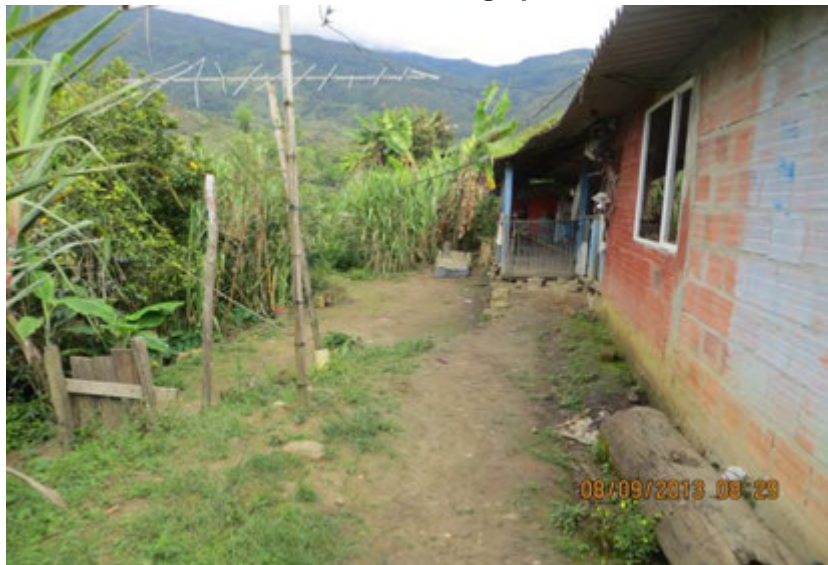
Fotografía 32. Casa construida en zona de alto riesgo por el movimiento del terreno.
