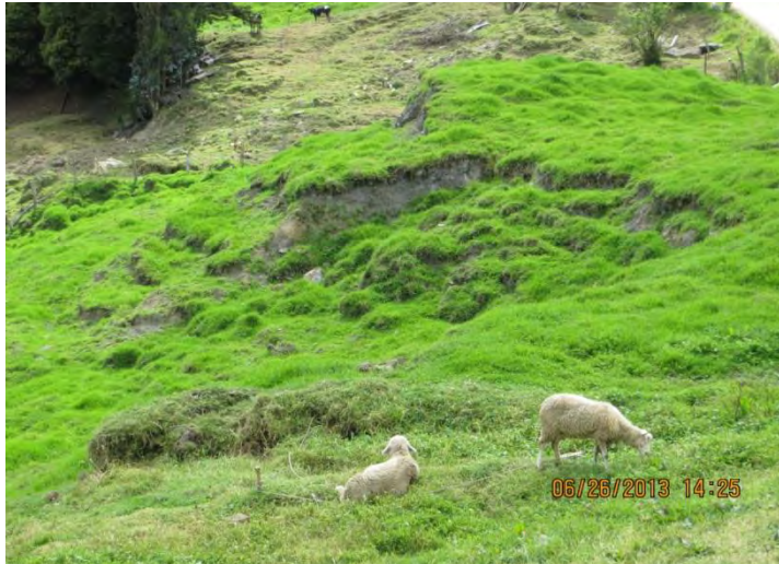
Fotografía 31. Hundimiento de terreno parte baja del deslizamiento.
