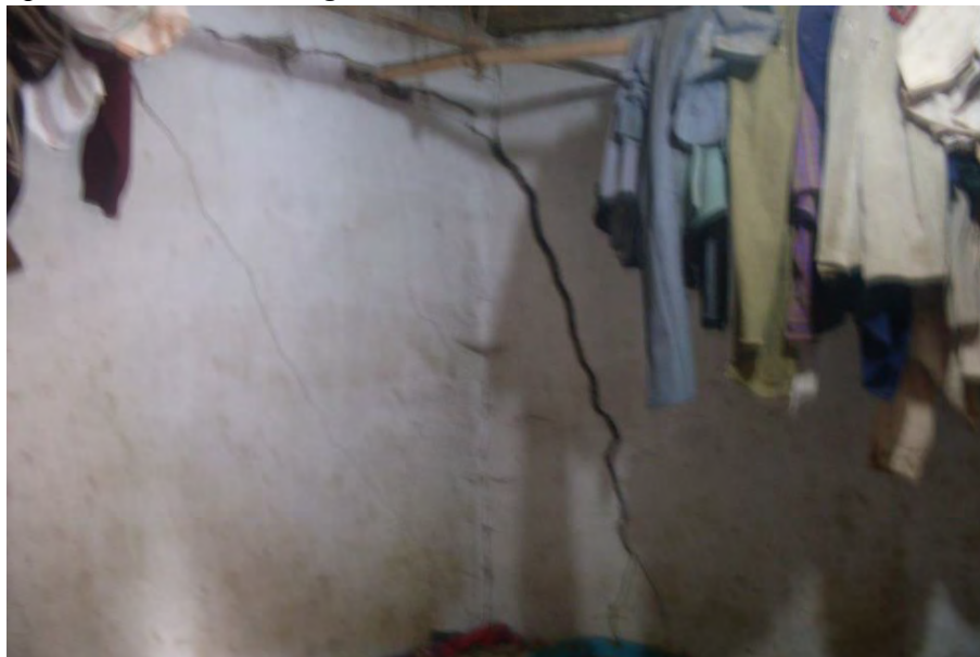
Fotografía 36. Muros con grietas de más de dos centímetros.
