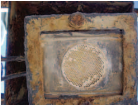
Figura 7. Sensor de nivel deteriorado por la corrosión en la estación Molinos (Mejía & Botero, 2008).
