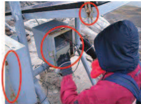
Figura 8. Corrosión de los elementos de algunas estaciones en las estructuras de soporte y seguridad para los elementos de medida (Mejía & Botero, 2008).
