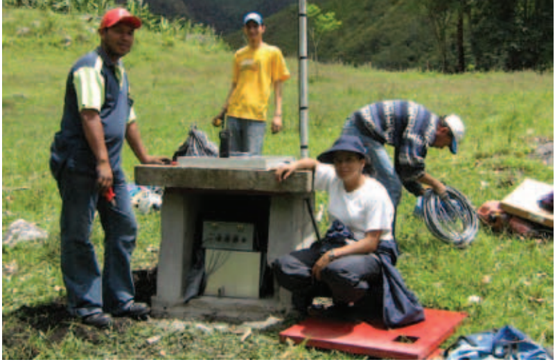
Foto 6. Monitor de flujos de lodo Calderitas, sobre el río Símbola.
