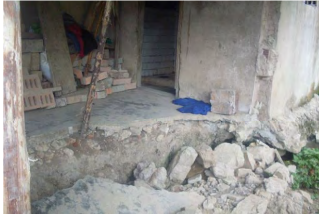
Fotografía 39. Vista de vivienda arrasada por el deslizamiento.
