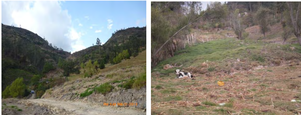
Fotografía 25. Panorámica de la zona de deslizamiento
