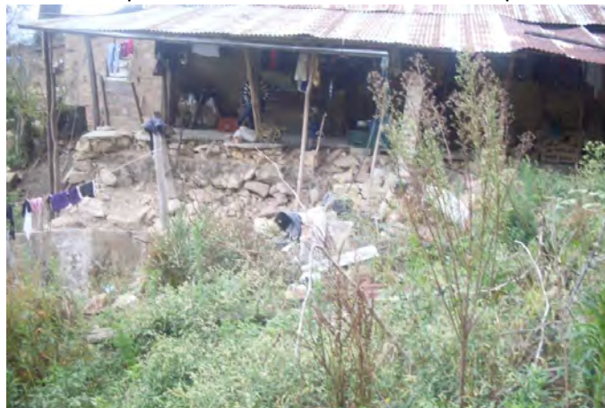
Fotografía 36. Vivienda con desprendimiento de construcción de la parte frontal.
