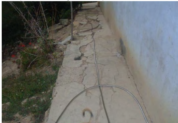
Fotografía 35. Vivienda con presencia de grietas en pisos.
