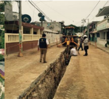
Alcantarillado Distrito 4. Natania
