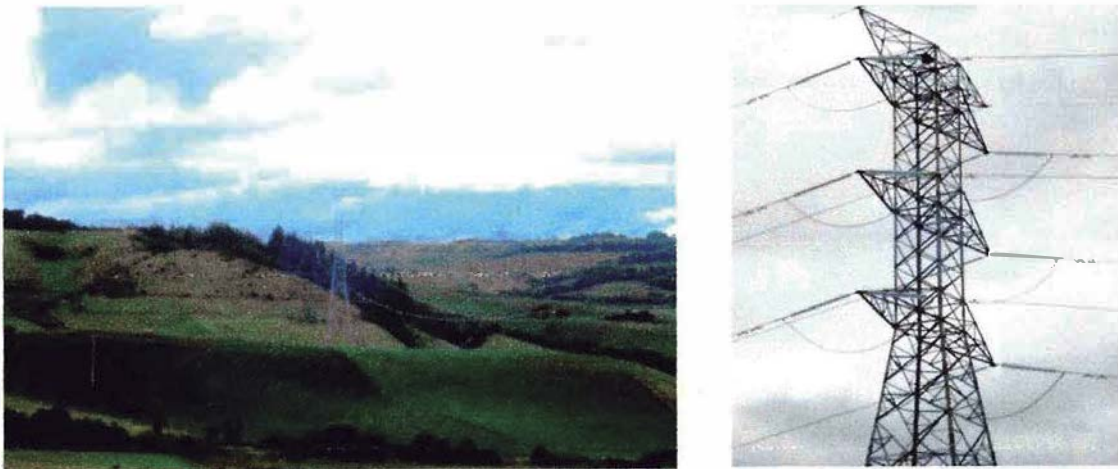
Figura 4. Línea de 230 kV perteneciente a la EEB
