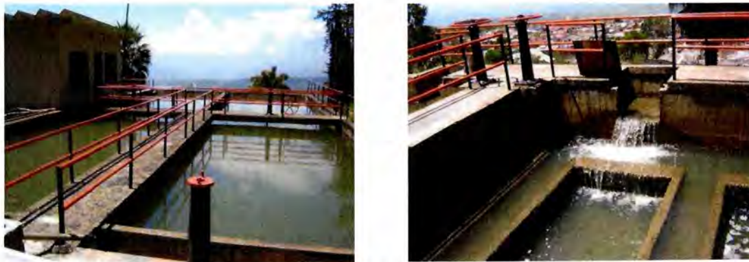
Figura 121. Sedimentadores y Filtros.
