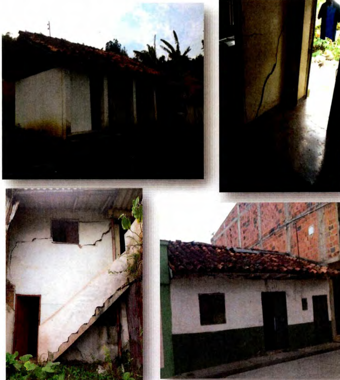
Figura 34. Registro fotográfico, Edificaciones en Tapia pisada con deficiencias en el sistema como agrietamientos tipo capilar hasta grave deterioro de la estructura.
