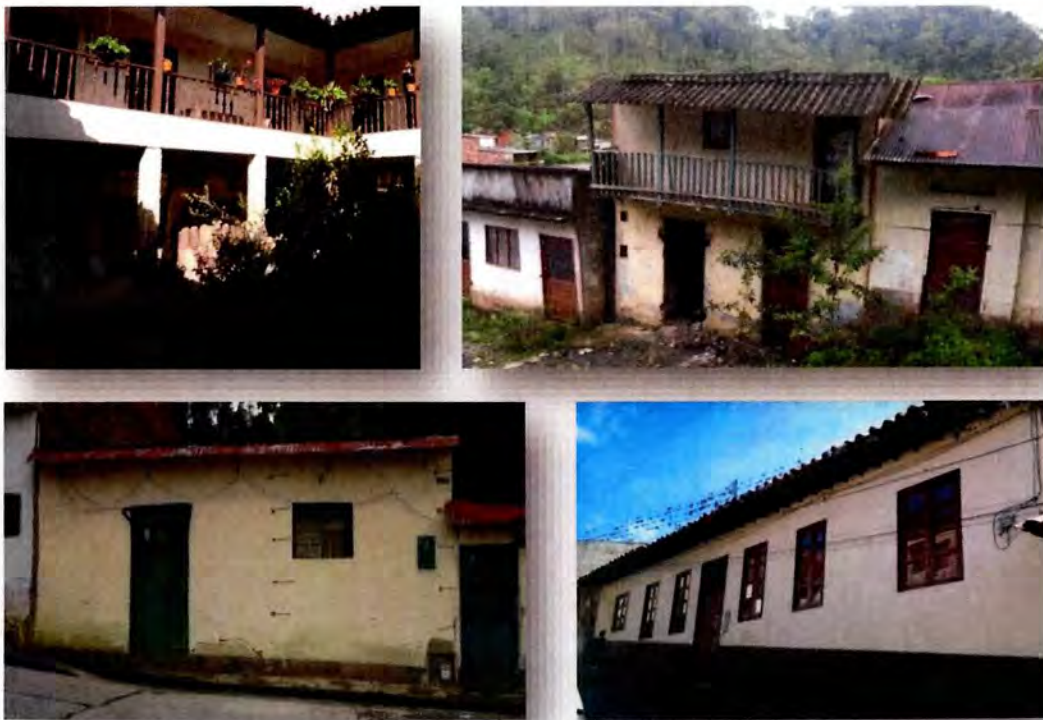
Figura 29. Registro fotográfico, Edificaciones en Tapia pisada que presentan deficiencias en el sistema. Levantamiento General Municipio de Vélez.
