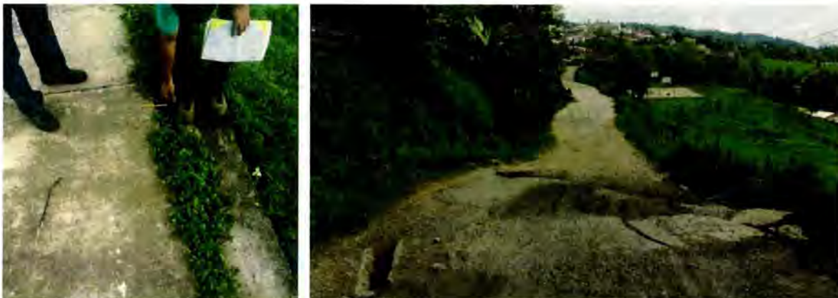
Figura 100. Problemas en el barrio Ricaurte y San Andresito.
