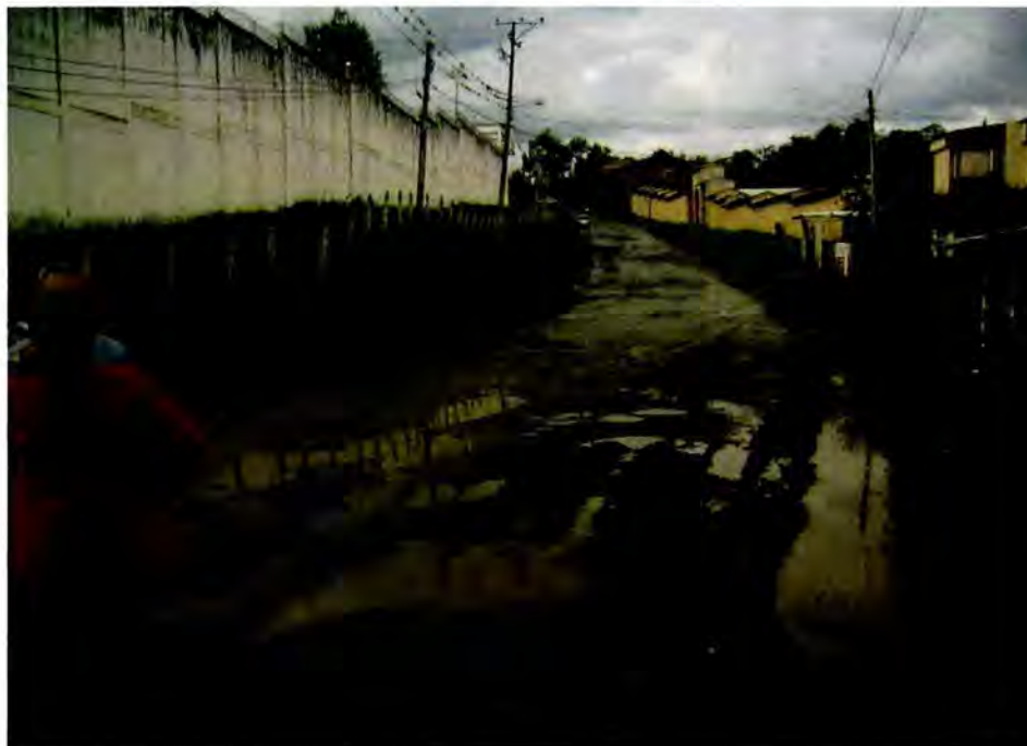
Figura 73. Tramo en proceso de hundimiento.
