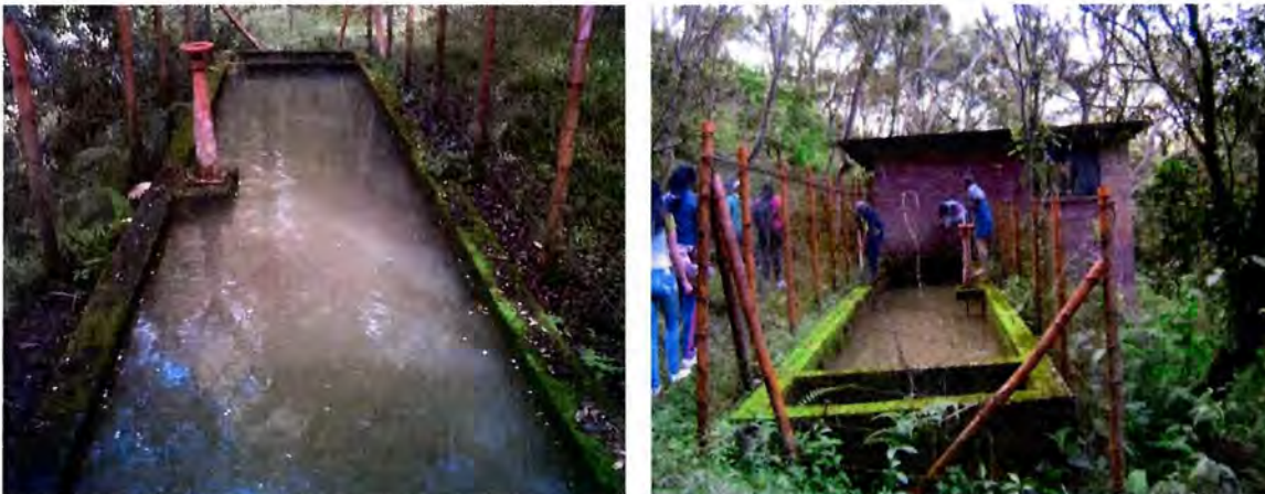
Figura 115. Desarenador sobre la Quebrada Pozo Verde.
