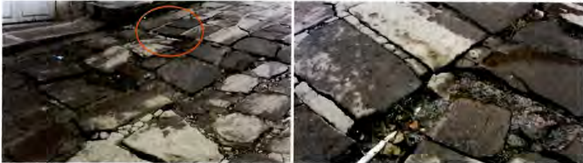
Figura 122. Fuga sobre un tramo de la red secundaria.
