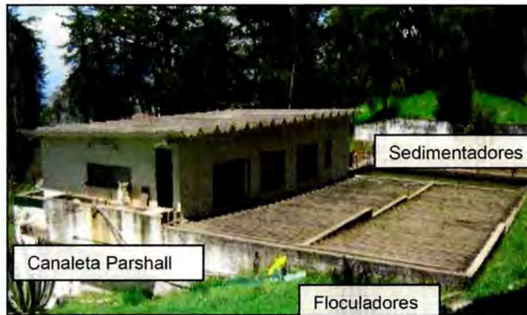
Figura 120. Planta de Tratamiento.
