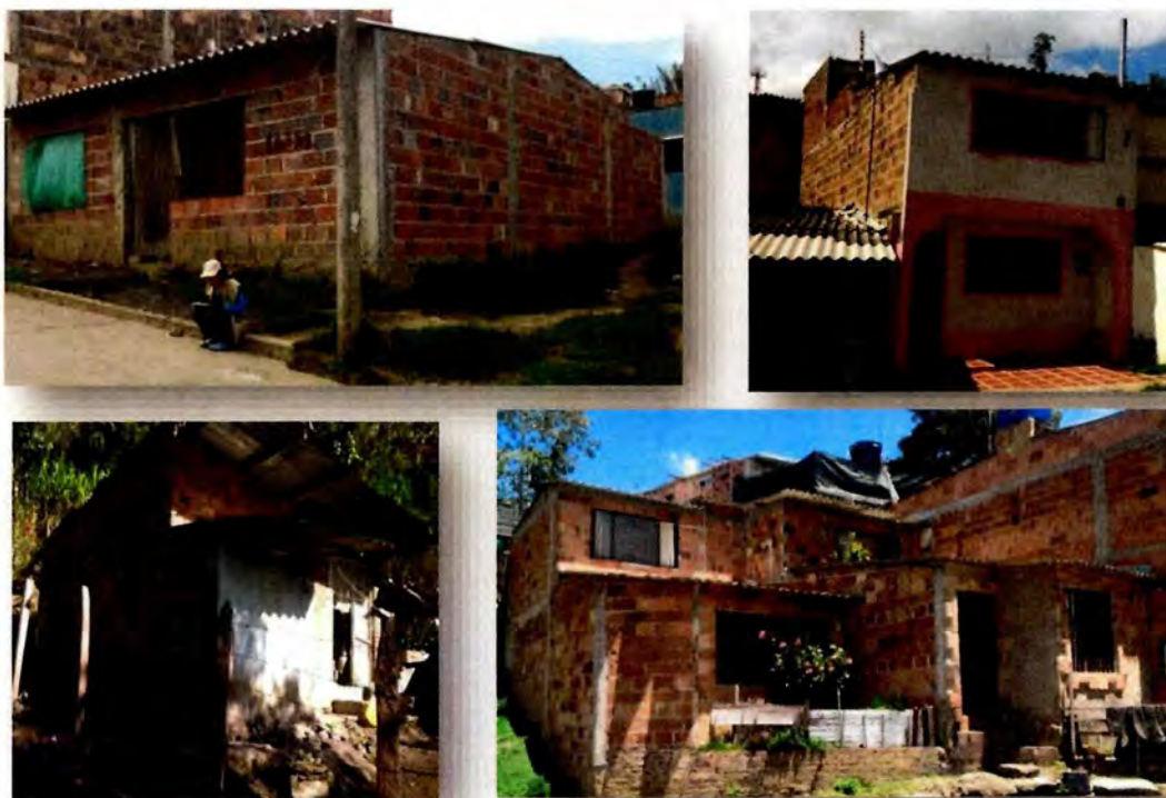
Figura 25. Registro fotográfico, Edificaciones en mampostería confinada con deficiencias en el confinamiento de sus muros de mampostería. Levantamiento General Municipio de Vélez.
