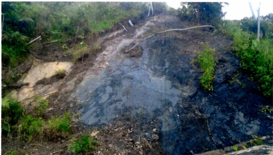
Figura 18. Talud de corte vial afectado por deslizamiento traslacional, en rocas de K1s. Vda. el Recreo, inventariado como el MM33 (ver sección 6.11).
