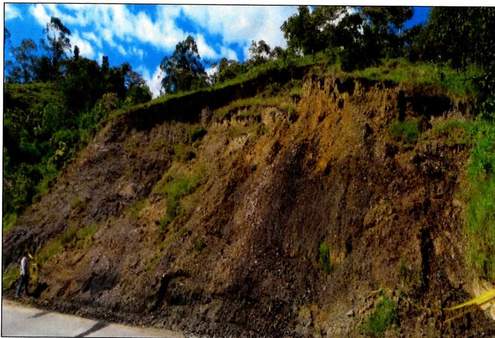
Figura 53. Deslizamiento en talud de corte en Peña Grande (KM45+570).
