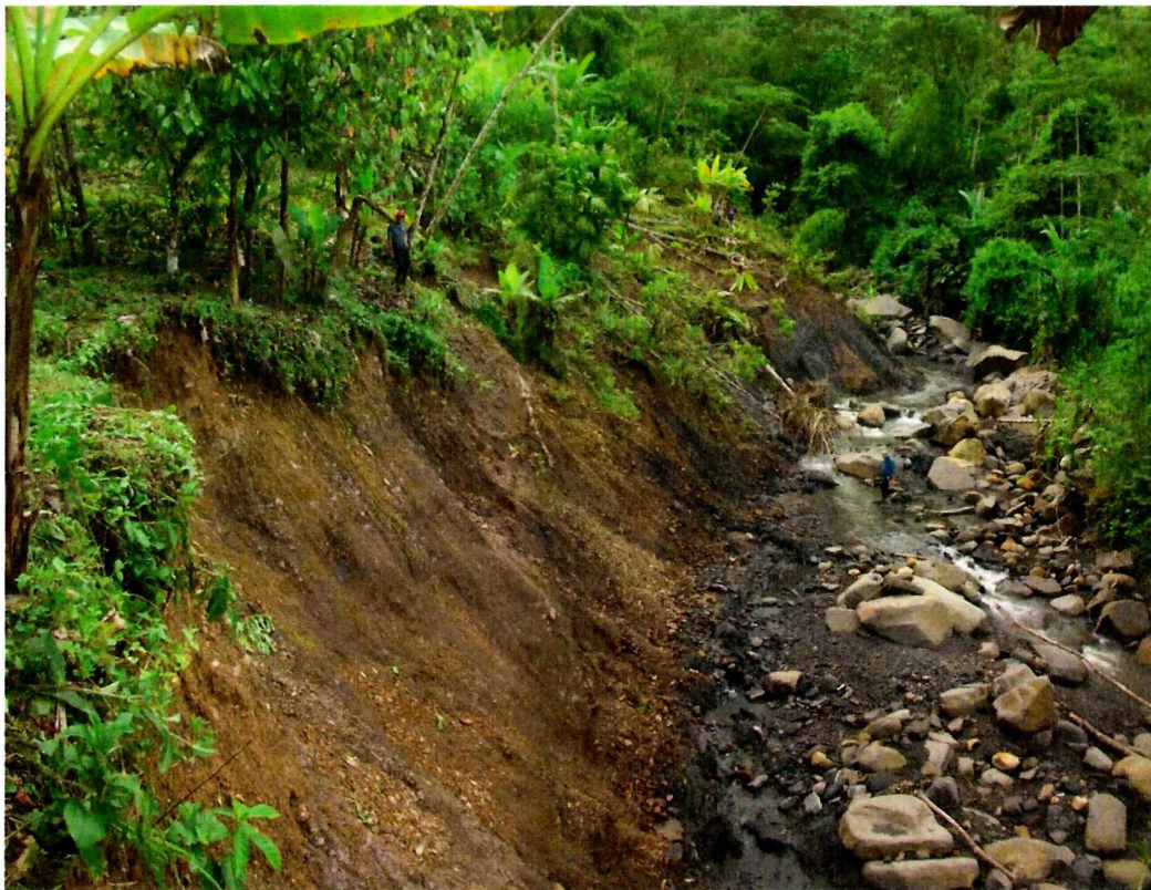
Figura 67. Socavación de la quebrada La Balsita (vista hacia aguas arriba), que genera orillales, de hasta 11.5 m de altura, e inestabilidad de calificación 5 al extremo izquierdo.
