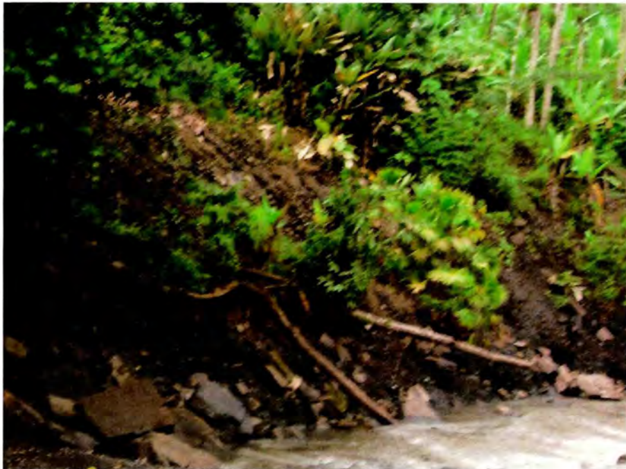
Aspecto del coluvión afectado por el MM10, vereda Limoncito
