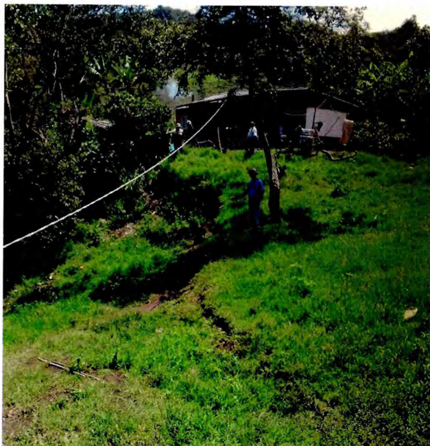
MM24, Escarpe principal (frente a las personas) y grietas (en primer plano) del deslizamiento traslacional, en el predio el Naranjito bajo, vereda San Vicente, Sector III - El Porvenir
