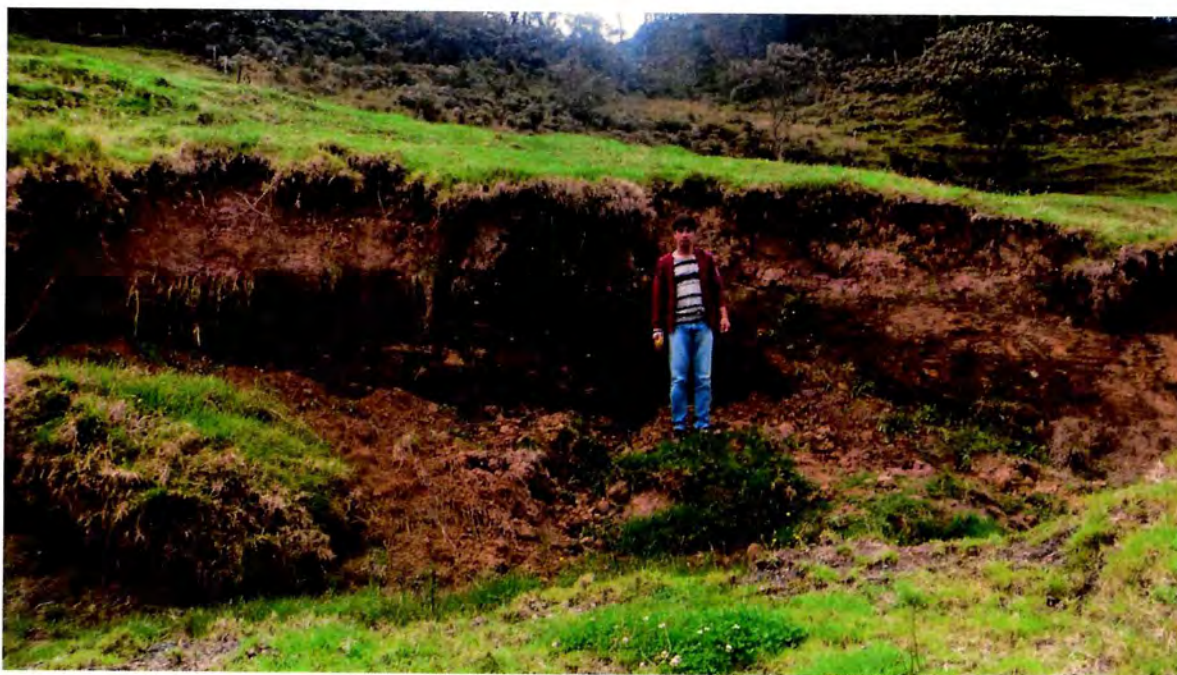
MM29, deslizamiento traslacional en la vía hacia la vereda Tubavita. Vereda Peña Tambor
