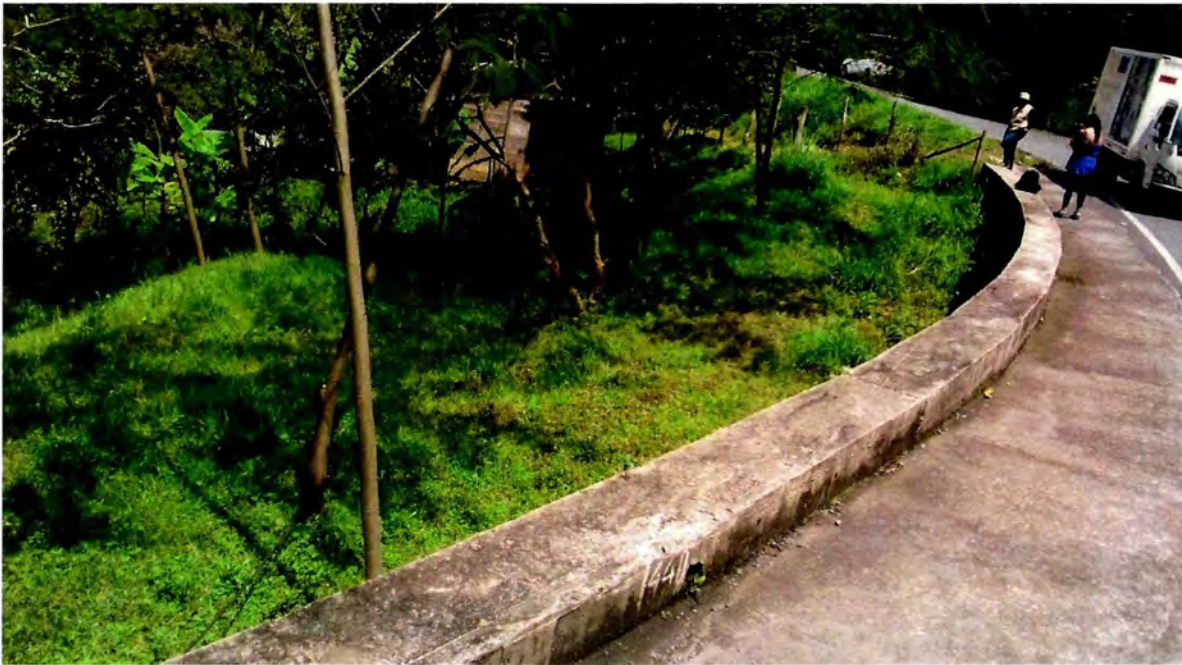
MM20, inactivo por muro contención, KM61+300, vereda Aco - Peña Blanca
