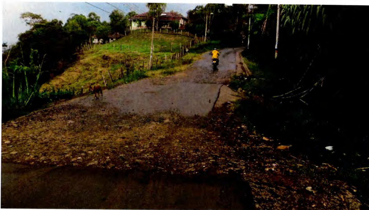
MM28, que afecta la vía La Paz hacia Vélez (al fondo)
