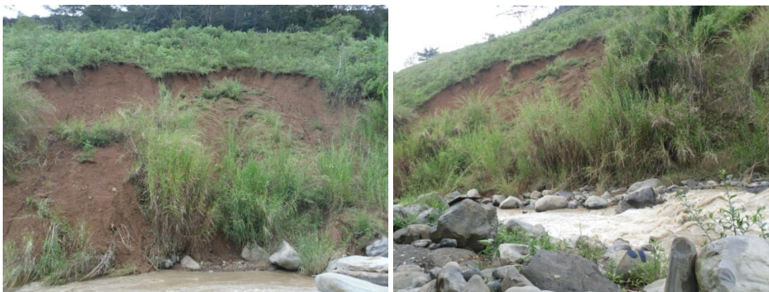
Fotografía 5-15 Deslizamiento en fente del matadero municipal.
