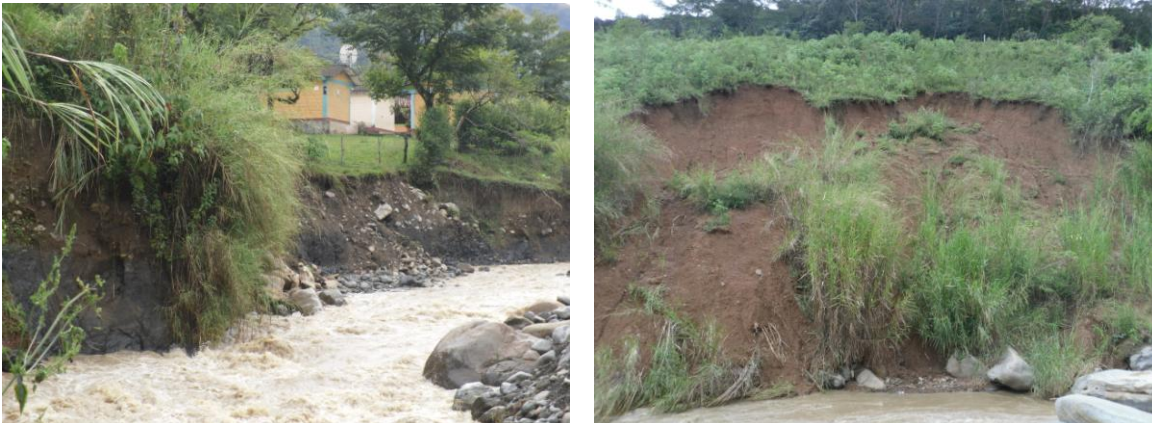
Fotografía 3-7 Socavación lateral del Río especialmente en meandros.
