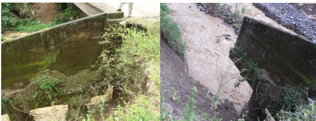
Fotografía 5-13 Socavacion lateral en el puente cercano a la plaza de mercado.
