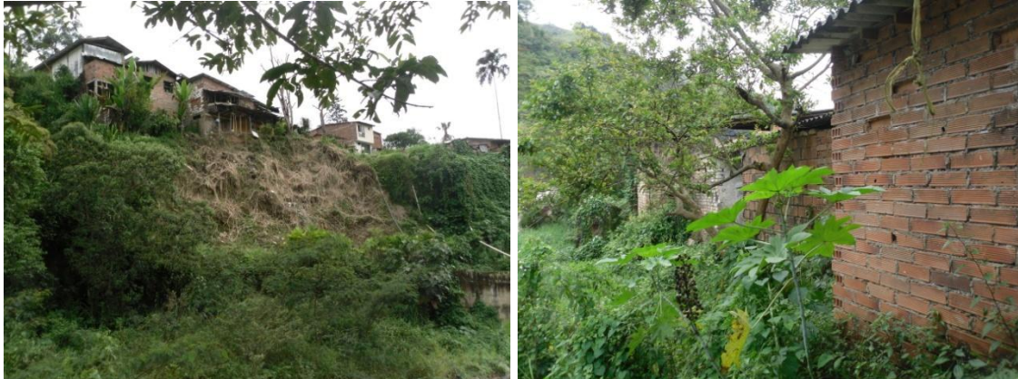
Fotografía 5-10 Deslizamiento en bomba de servicio.
