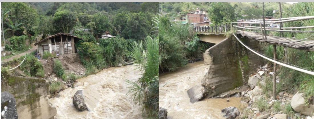
Fotografía 5-12 Inestabilidad de la margen del puente levantado en condiciones inadecuadas.
