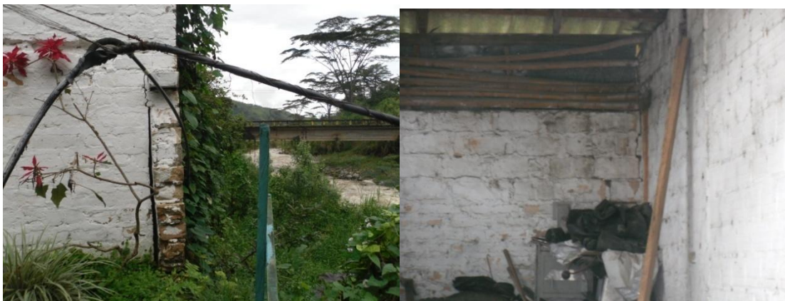
Fotografía 5-11 Afectación de las edificaciones por deslizamiento en bomba de servicio.
