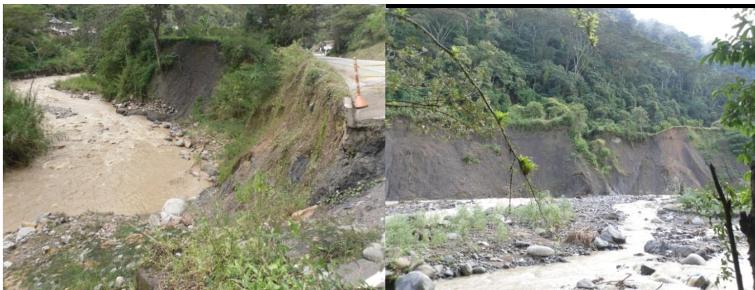
Fotografía 5-14 Inestabilidad de márgenes - inmediaciones a la variante.
