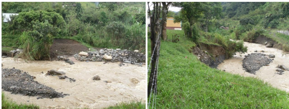
Fotografía 5-7 Inestabilidad de las márgenes arriba de la confluencia con quebrada Llorona
