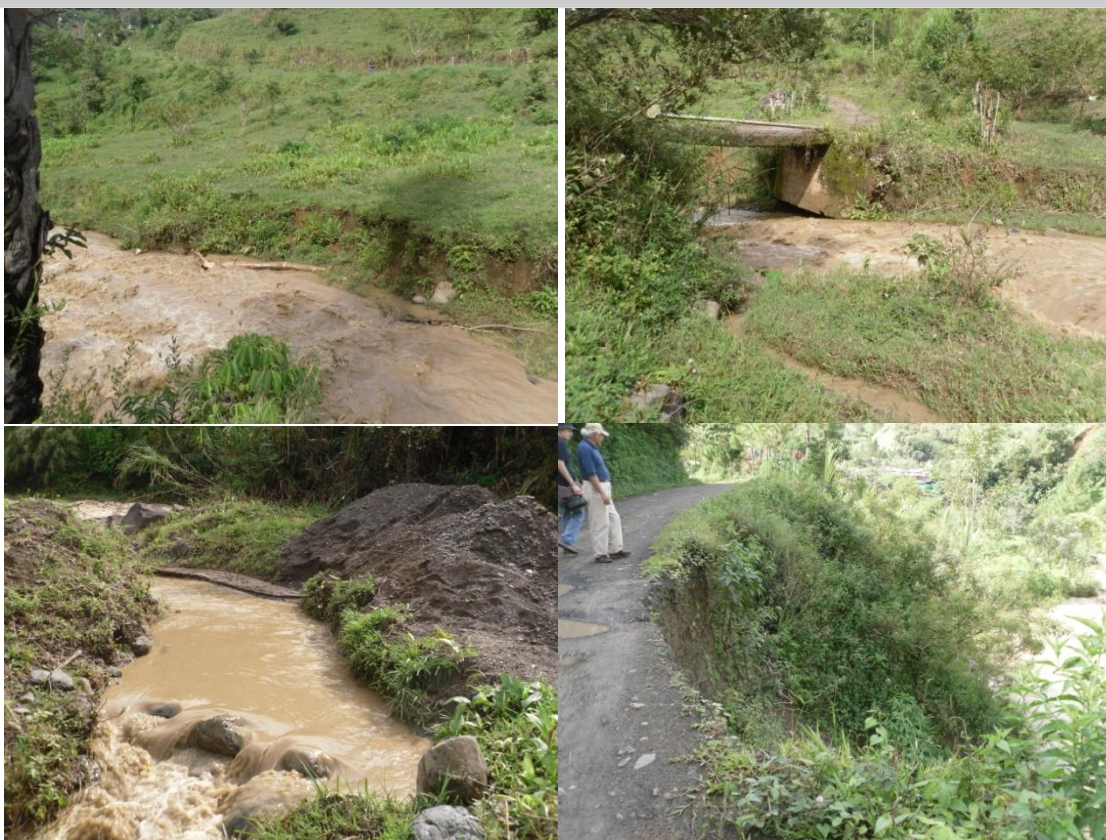
Fotografía 5-16 Socavación lateral en quebrada llorona.
