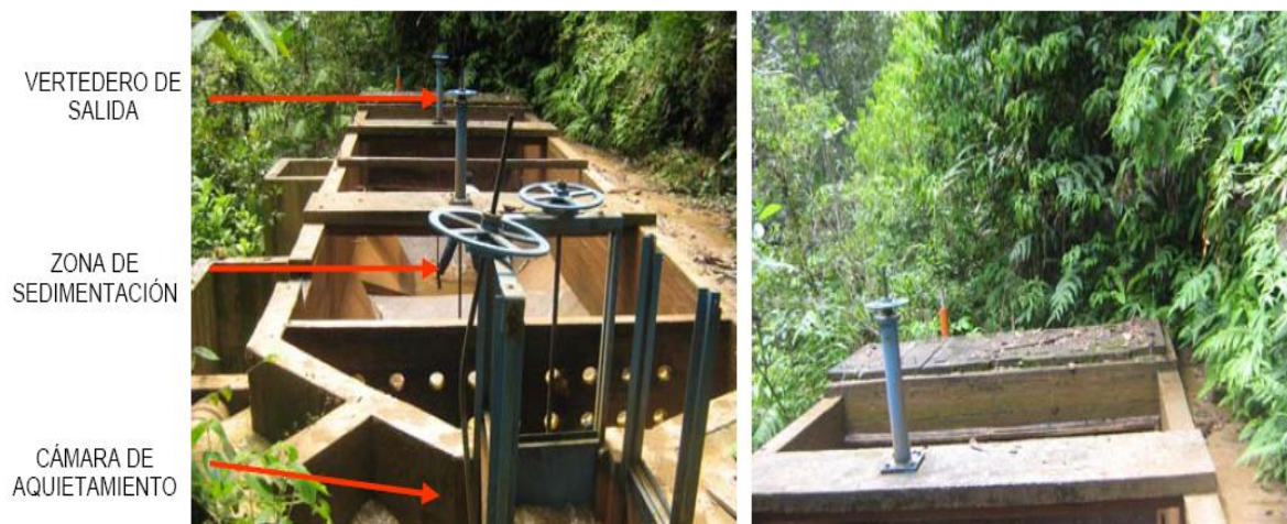
Figura 27: Desarenador quebrada El Arenoso
