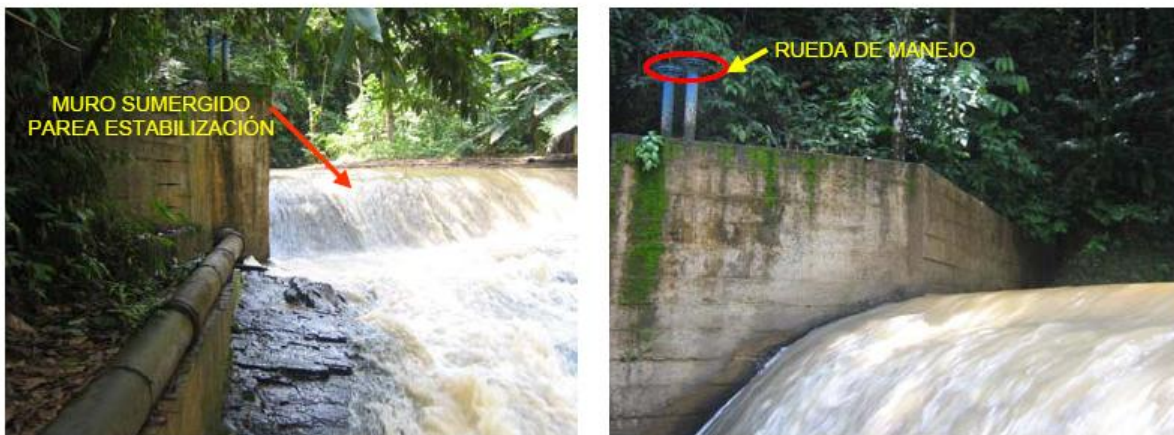
Figura 26: Bocatoma quebrada El Arenoso
