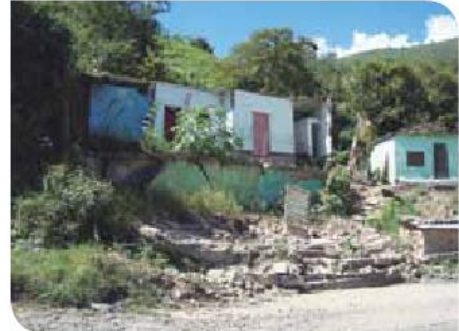
Algunas viviendas se encuentran en riesgo, por eso la comunidad asumió su acción en Gestión del Riesgo.
