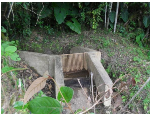
Foto 7.7. Bocatoma Acueducto Gachalá vereda Centro Rural
