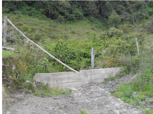
Foto 7.10. Bocatoma Acueducto Gachalá vereda Centro Rural
