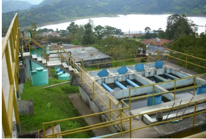
Foto 7.66. Planta de potabilización de agua Municipio de Gachalá
