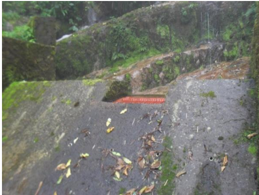
Foto 7.1. Bocatoma Acueducto Gachalá vereda Andes
