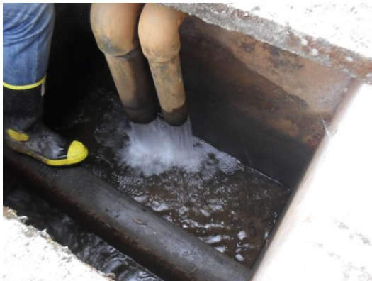
Foto 7.11. Cámara de Conducción Acueducto Gachalá vereda Centro Rural
