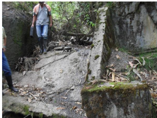
Foto 7.6. Bocatoma Acueducto Gachalá Vereda Escobal
