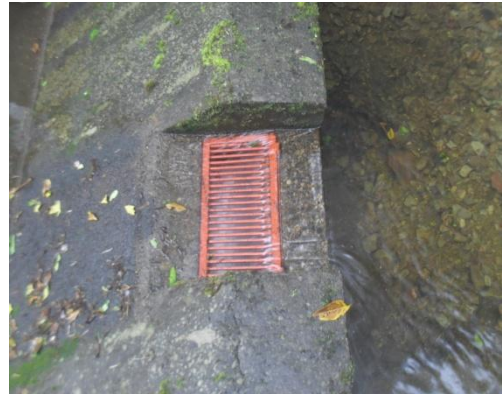
Foto 7.2. Bocatoma Acueducto Gachalá Vereda Andes
