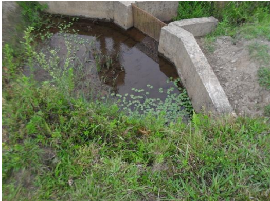
Foto 7.9. Bocatoma Acueducto Gachalá vereda Centro Rural
