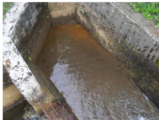
Foto 7.8. Desarenador Acueducto Gachalá vereda Centro Rural
