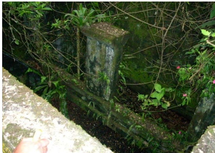
Foto 7.67. Infraestructura deteriorada y en abandono de antigua PTAR
