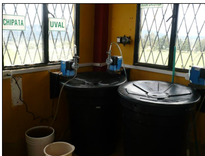
Foto 31. Foto 9. Planeación Ecológica Ltda. -Laboratorio de la planta de tratamiento de agua potable.
