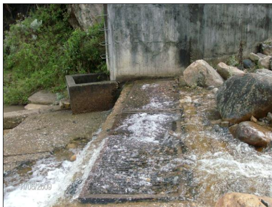
Foto 6. Fuente: Corpoguavio - Planeación Ecológica Ltda, 2009 -Rejilla del sistema de captación de la quebrada Uval.
