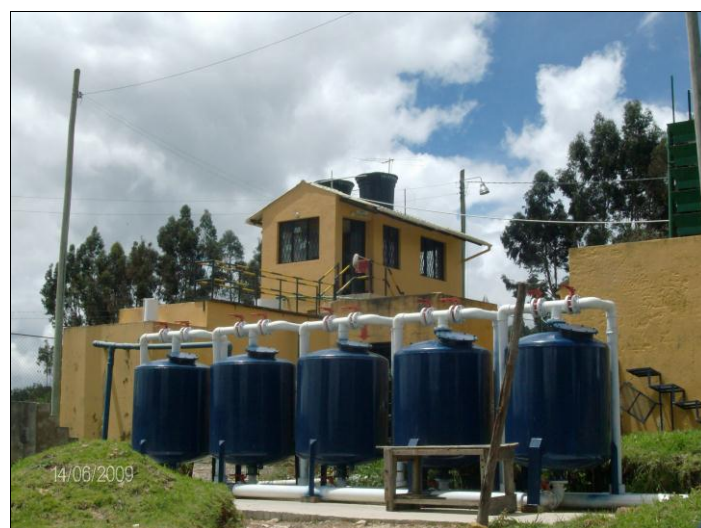
Foto 8. Fuente: Corpoguavio - Planeación Ecológica Ltda, 2009 -Tanques de almacenamiento del proceso de potabilización.
