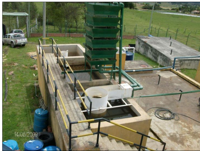
Foto 7. Fuente: Corpoguavio - Planeación Ecológica Ltda, 2009 -Planta de tratamiento de agua potable de Guasca.
