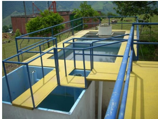
Foto 7-1. Planta de potabilización de agua del municipio de Medina
