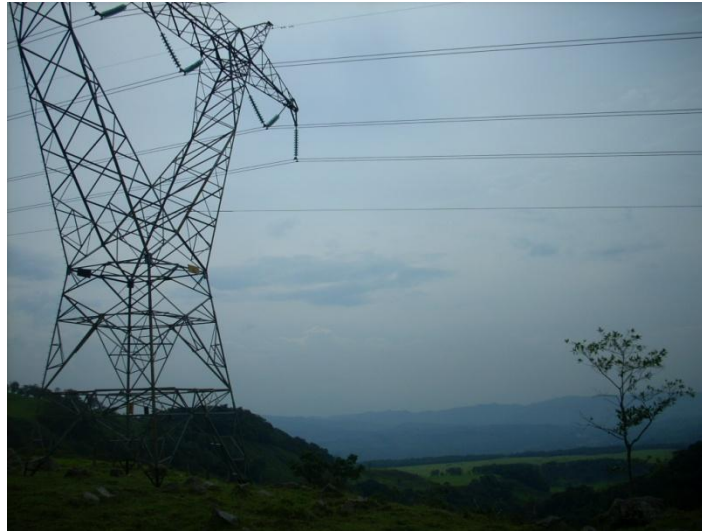
Foto 7.33 Torre de energía línea de conducción Guavio-Villavicencio-Tunal
