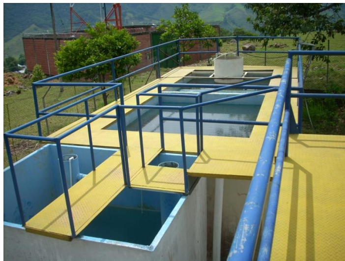
Foto 7.24 Planta de potabilización de agua del municipio de Medina
