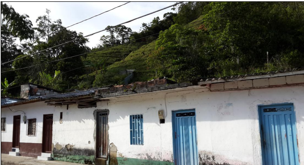
Fotografía 5. Barrio La Viejita, nótese el proceso de reptación en los taludes y el drenaje que limita con la parte trasera de algunas viviendas.
