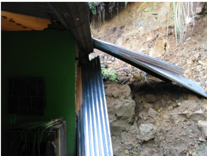
Foto 21. Vivienda en la vereda Sarvith que presenta riesgo por deslizamiento. Propietario Emiro Sánchez. Se emitió orden de desalojo en el año 2011.
