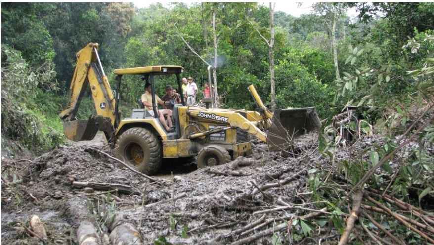
Foto 17. Deslizamiento sobre la vía Santo domingo a la Vereda la Herradura en predio de la señora Ana Edilma Parra, se dio orden de desalojo, se presentó en Abril de 2011.
