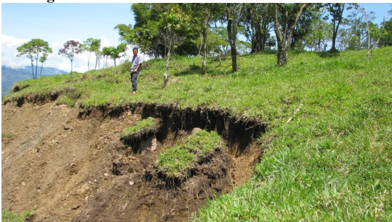
Foto 20. Afectación por deslizamiento vereda Dominguito predio del señor Luis Guzmán.
