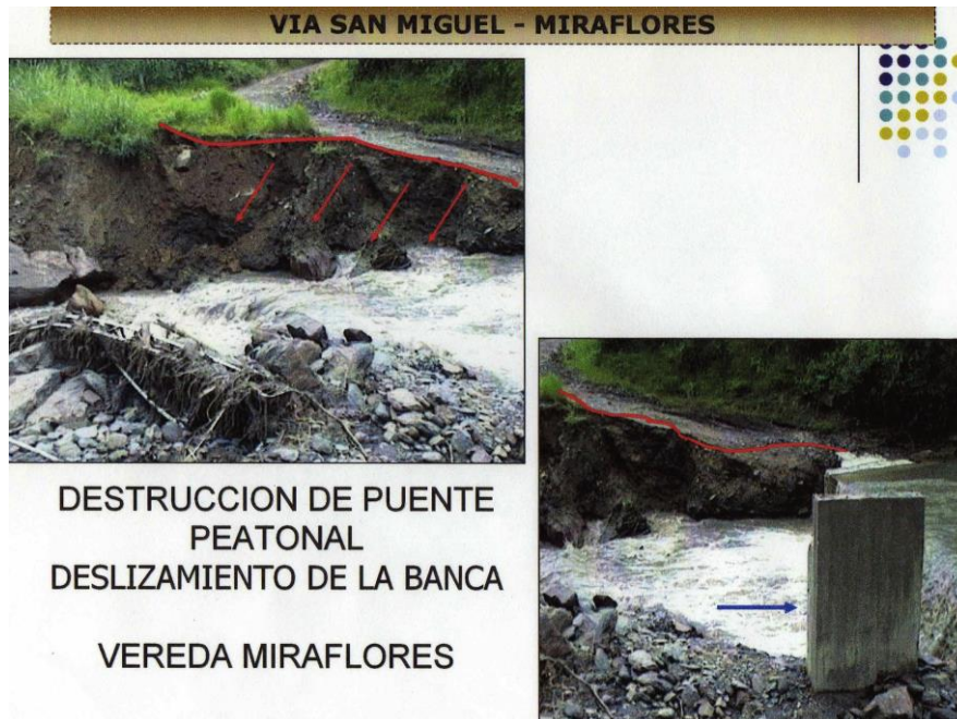
Foto 9. En la que de la vereda San Miguel conduce a la Vereda Miraflores se presenta deslizamiento que causo perdida de parte de la vía y daño en el 95% de la estructura del puente peatonal.
