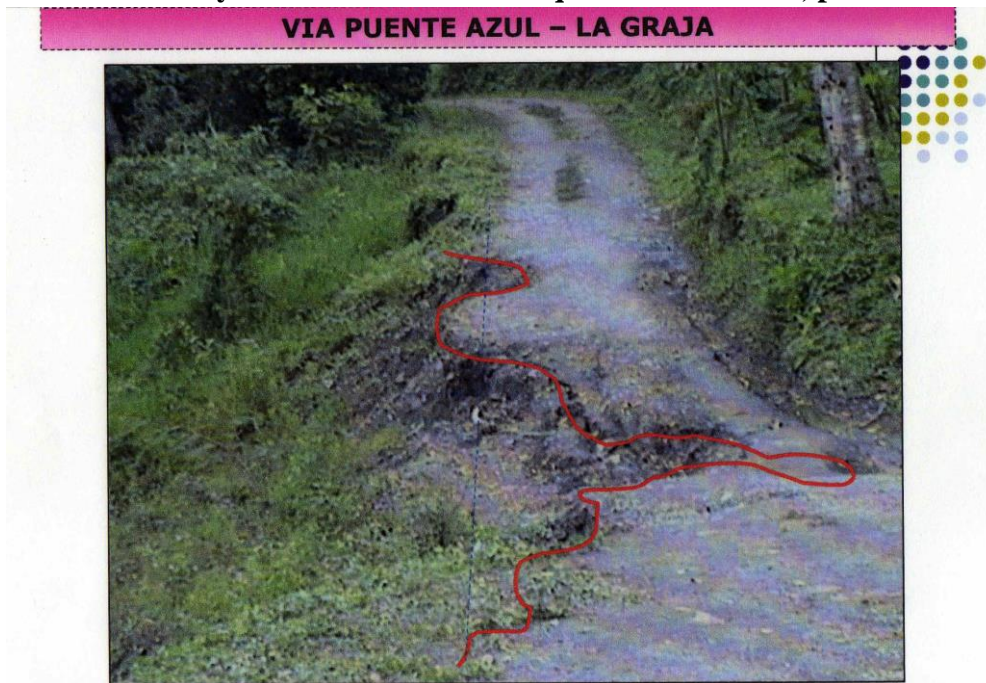
Foto 6. Deslizamiento quebrada Miraflores, sitio Puente azul, se presenta afectación de la vía que conduce a la vereda Campo Alegre “La Granja”.
