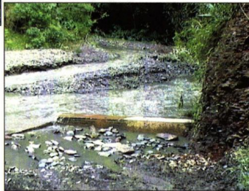
deslizamiento en la vía a la vereda Santa Rosa.
