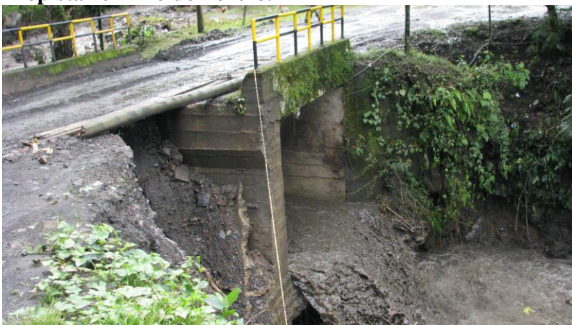
Foto 23. Deslizamiento en la vía afectando al puente en la vía a muzo sitio La Herradura.
