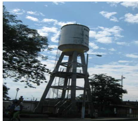
Tanque Almacenamiento de agua
