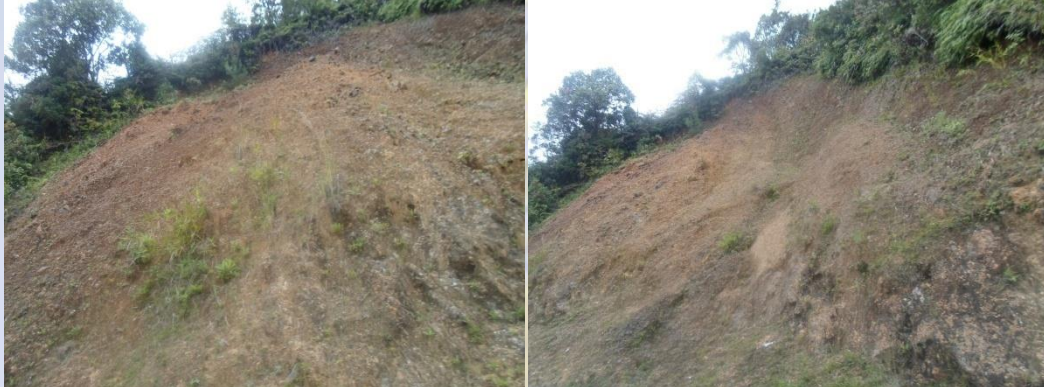
Taludes erosionados en la margen XXX de la vía...
