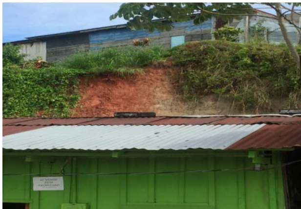
Barrio San Martín, Cerro San Martín. Presenta deslizamientos de la banca.
