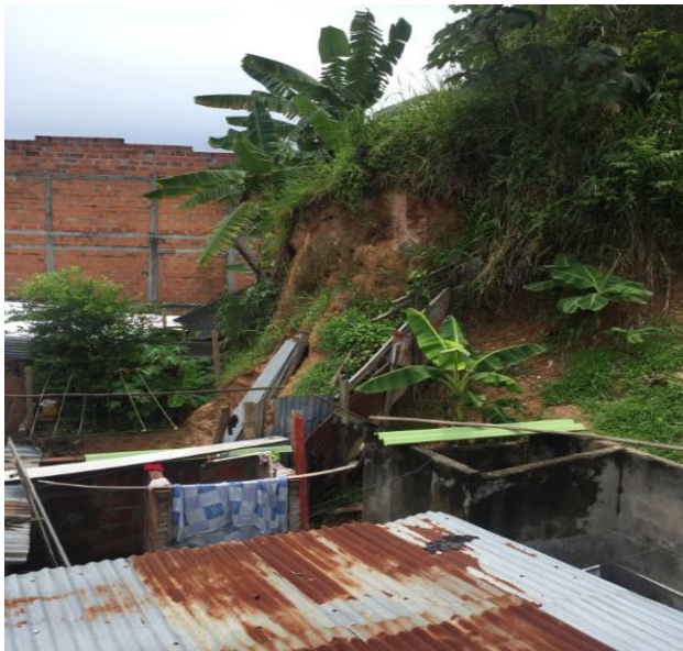
BARRIO LA MALENA SECTOR (CURVA ALTO) Presenta deslizamiento de la banca, poniendo en riesgo Unas 15 familias.
