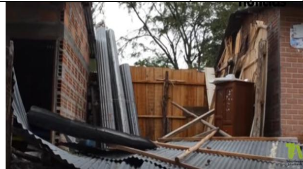
Desastre por mal amarre de techos de zinc de techo de zinc https://www.youtube.com/watch?v=uPmf1Zpi2Xk
