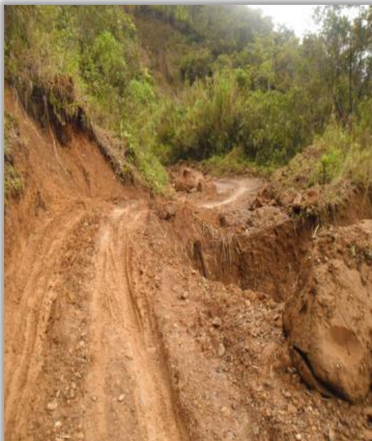
Fotografía 6 Deslizamiento Vía Villa Clareth
