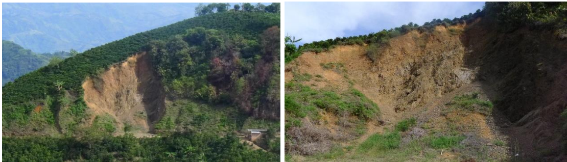
Foto 50. Deslizamientos asociados a cortes de las vías y antiguas canteras
