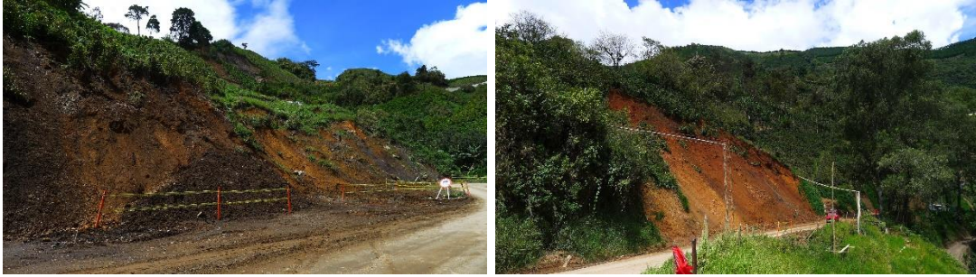
Foto 51. Deslizamientos asociados a cortes de las vías que conduce al Carmen de Atrato
