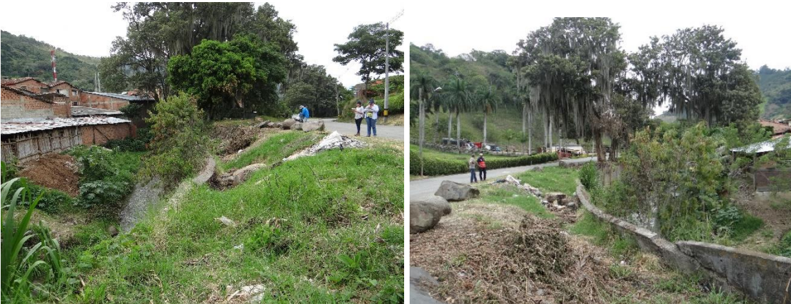
Foto 87. Proceso de socavación frente a institución educativa San José de Citará
