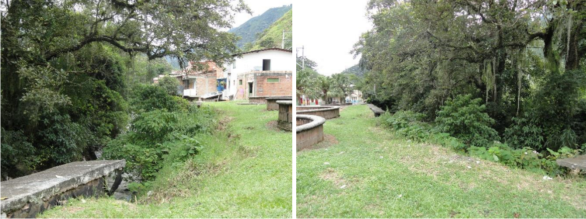
Foto 86. Proceso de socavación en el barrio Chapinero
