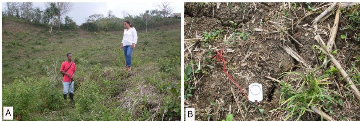
Figura 71. Detalles en la periferia del volcán de lodo Las Changas. A ). Hundimiento del suelo de aproximadamente 1m. B ) Grietas centimétricas (< 5 cm) que se extienden en forma radial. Fotos: Ana Lucía Pérez Calle.
