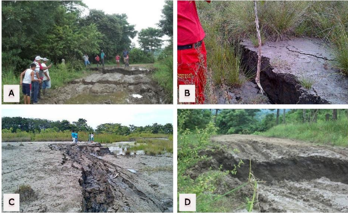
Figura 35. Red de fracturas originadas del evento del 23 de octubre de 2012. A). Grietas simples con desplazamientos centímetros sobre la vía que conduce a la vereda Filo de Venus. B). Depósito de arcillas en el área cercana al cráter principal. C). Conjunto de grietas asociadas a desnivel del terreno en el cráter principal. D). Parte cóncava de la vía cortada por una discontinuidad con movimiento horizontal y vertical. Fotos: Alberto Vivas Narváez.
