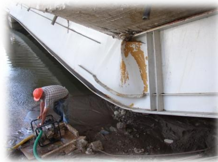
Fotografía 3_Desplome de Vigas
