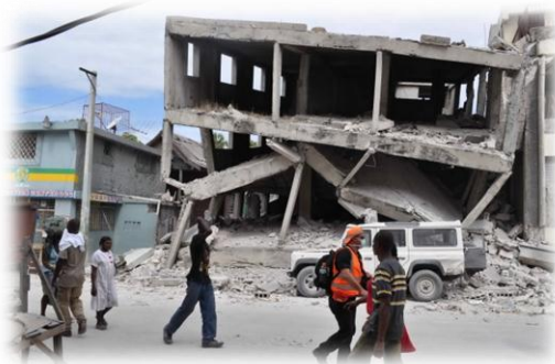
Fotografía 4_Desplome de Entrepiso
