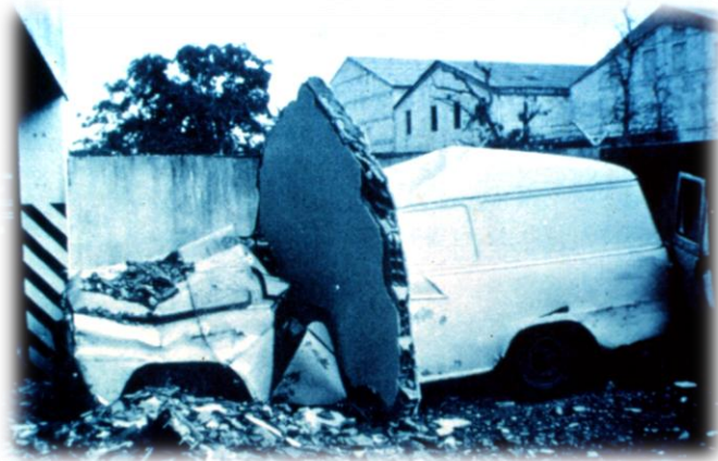
Fotografía 2_Desplome de muros
