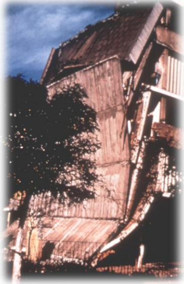
Fotografía 1_Desplome de columnas
