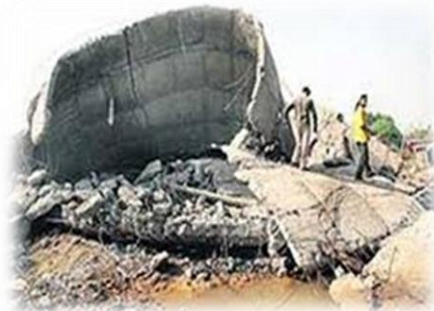
Fotografía 5_Desplome de Tanque
