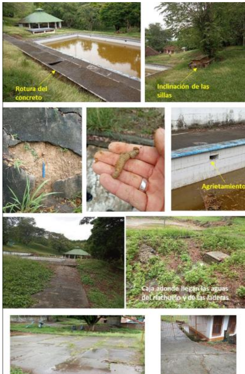
Figura 43 Instalaciones del Parque Recreacional en mal estado por inestabilidad del lugar.
