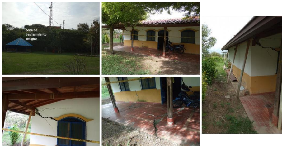
Figura 42 Mal estado de las instalaciones del SIM debido al movimiento del terreno.
