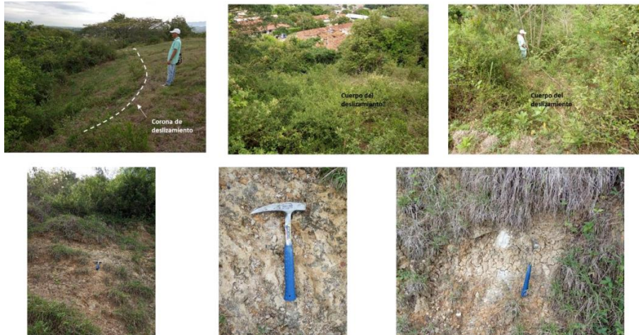
Figura 41 Deslizamiento del Barrio San Rafael, corona, cuerpo de deslizamiento y litología.
