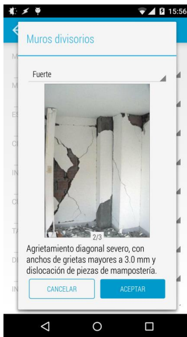
Figura 3-14 Nivel de daño de los elementos no estructurales
