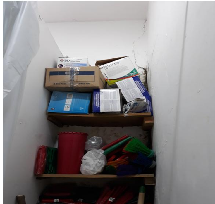
Figura. 28. Fracturas en la estructura de la cárcel de Pácora.
