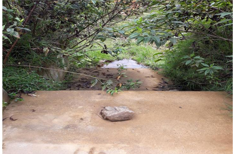
Figura. 22. Dique que no cumple su función.
