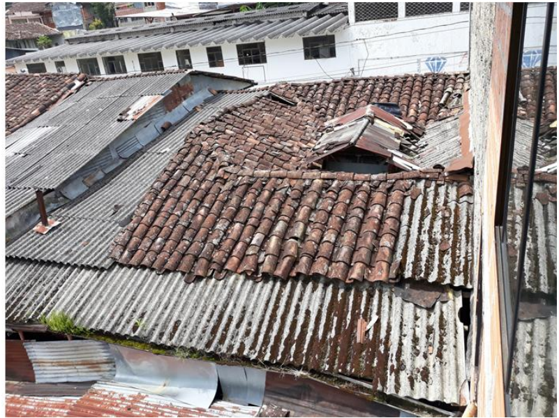
Figura. 23. Techos de viviendas en mal estado en el sector comercial. En el sector rural los más afectados son los Corregimientos de San Bartolomé, Los Morros y Las Coles.
