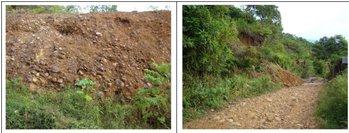
Taludes de las antiguas terrazas aluviales y los pequeños deslizamientos que afectan las vías a los barrios.
