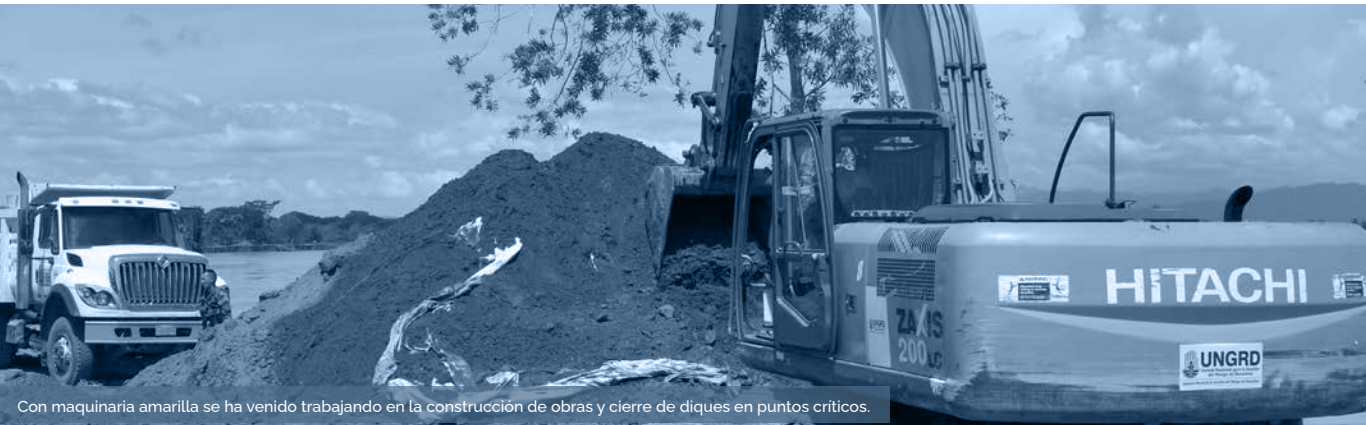
Labores con maquinaria amarilla para el control de la erosión en el sector Cara de Gato municipio de San Jacinto del Cauca.
