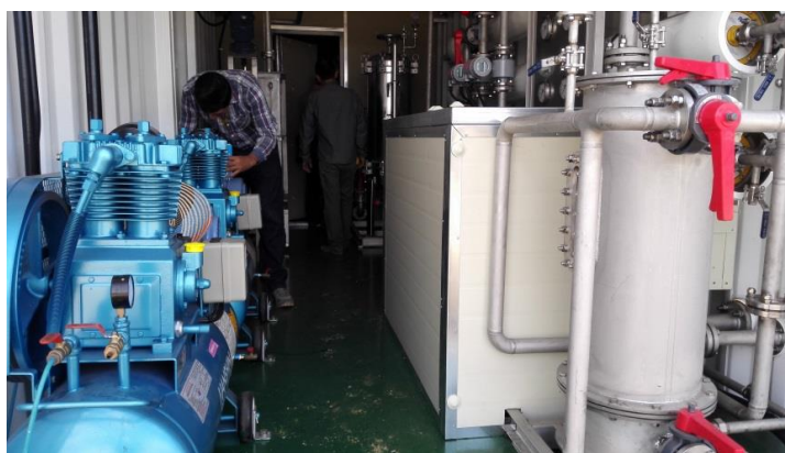
Planta desalinizadora donada por Corea para la entrega de agua potable a comunidades de Manaure
